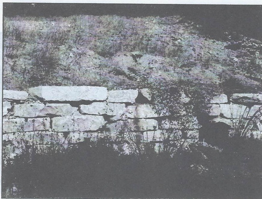
Photo 2 : Enrochement situé à la base du dépôt de résidus (branche ouest) en bordure de ruisseau
