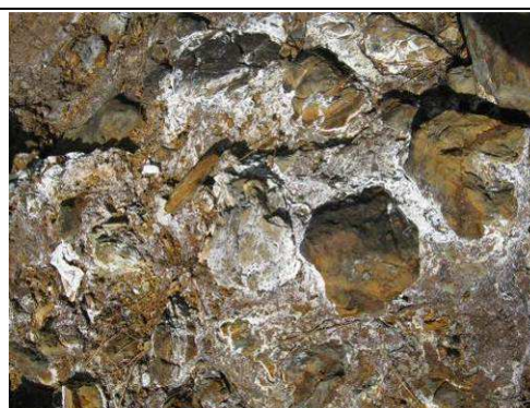
Photo 10 :Oxydation de surface (salpêtre)
